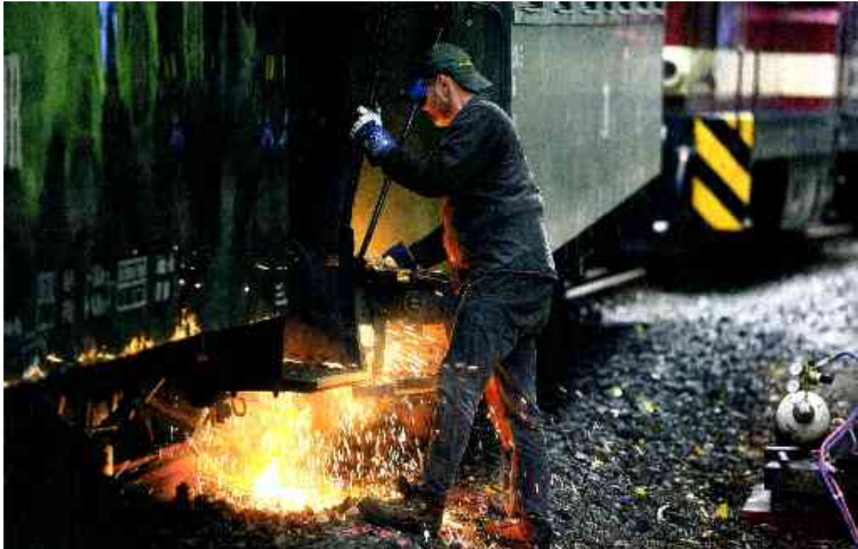
Ein Schweißer versucht, an der Unglücksstelle verkeilte Waggons der Lößnitzgrundbahn voneinander zu trennen
